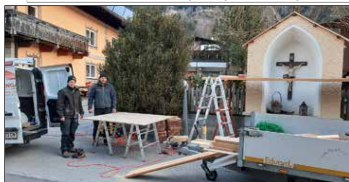
Im Zuge der Dachsanierung der Friedhofskapelle wurde auch das Dach beim Bildstöckl der Fam. Martin Gritzer (Watschger-Stöckl) neu geschindelt. Am Bild die Mitarbeiter der ausführenden Firma, Zimmerei Weingartner.
